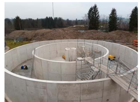
Die Reinigungsstraße für den Anschluss Steingaden an die Kläranlage Lechbruck am See nimmt langsam Gestalt an. Die Betonarbeiten sind weit vorangeschritten.
